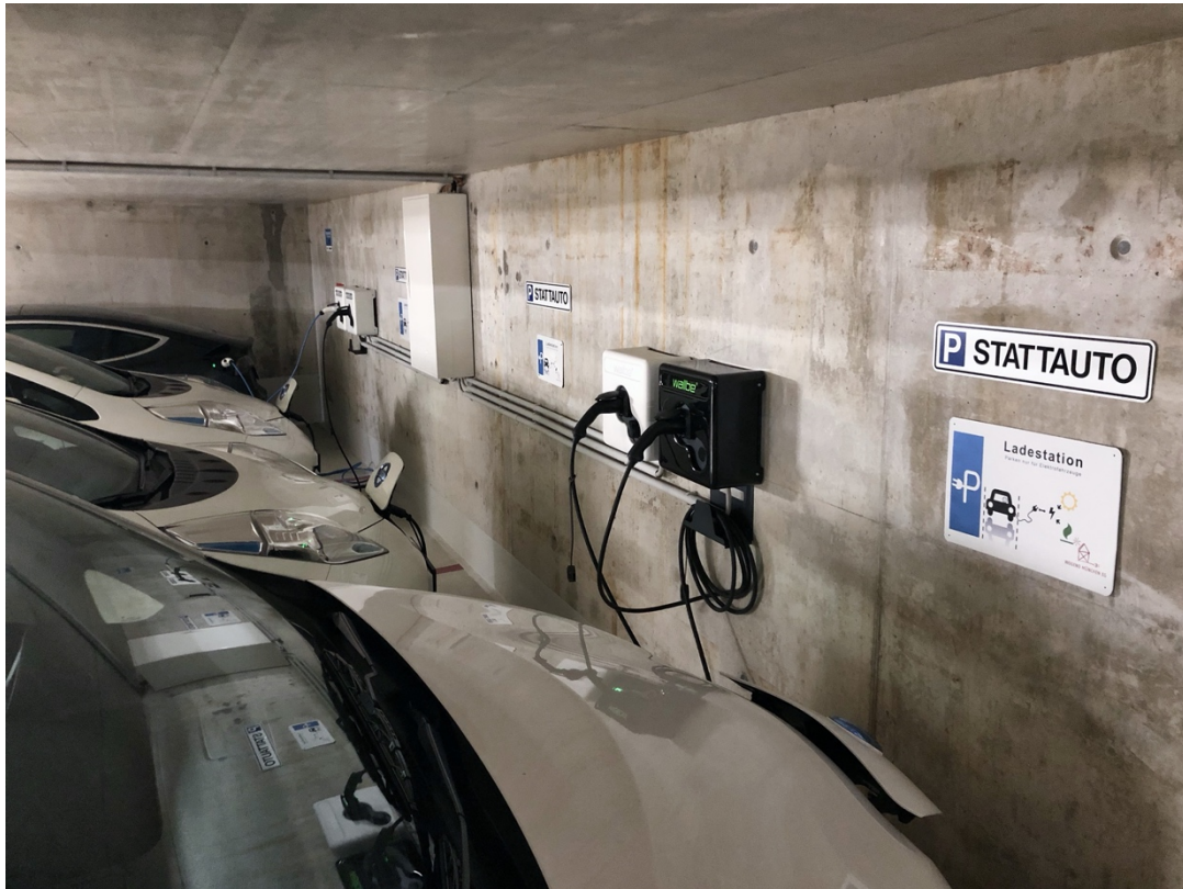
Lastmanagement für 4 Ladepunkte in der Tiefgarage Fritz-Winter-Str. 7 in München
